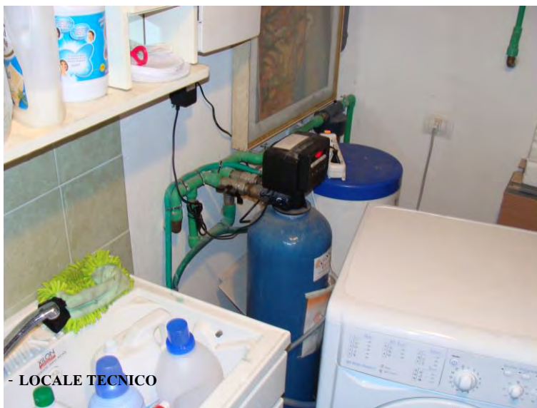
(PORTA ACCESSO) LOCALE TECNICO
